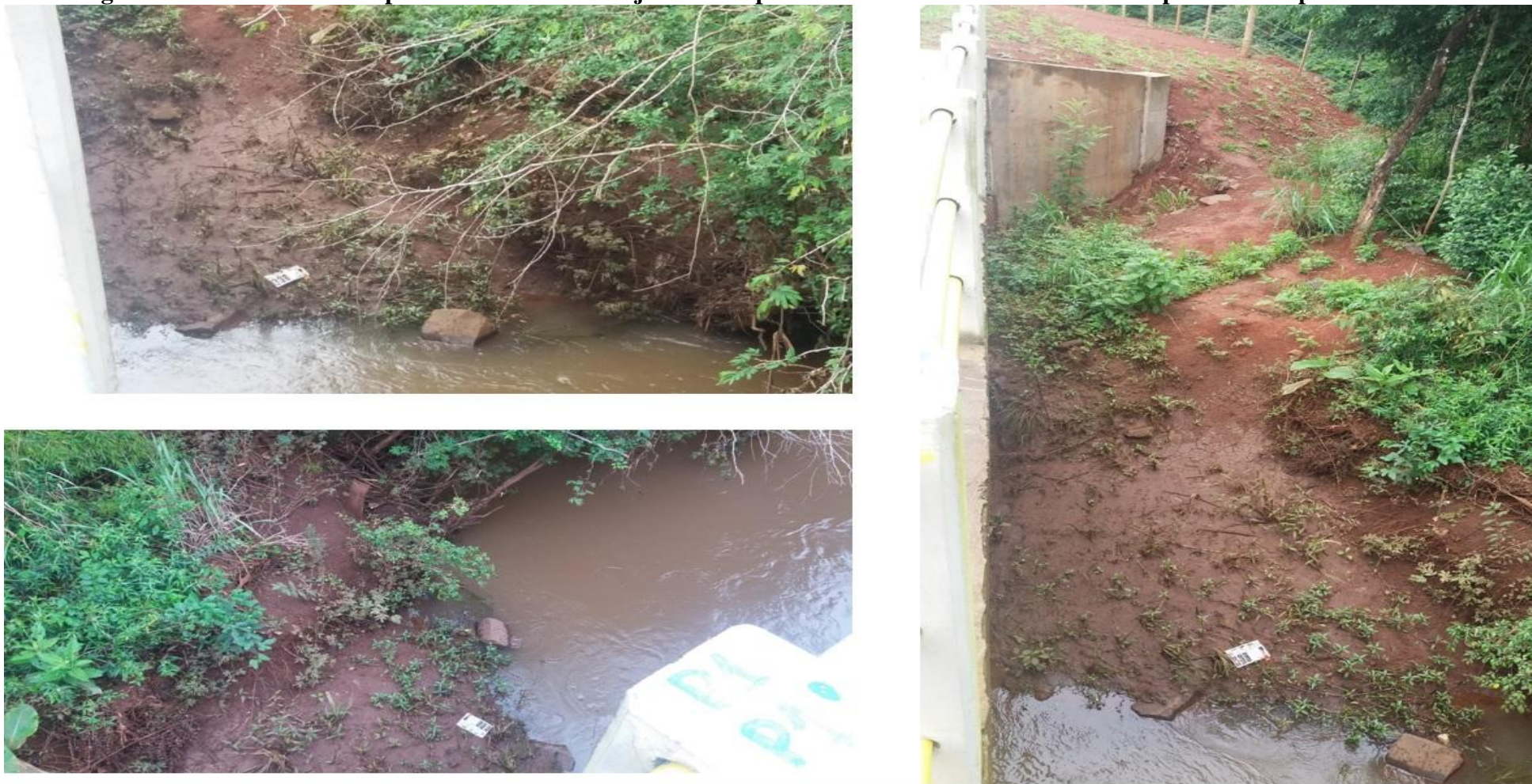
Figura 34: assoreamento na ponte construída no Laj. São José para entrada no Lot. Jardins Paraíso pela Av. Leopoldo Sander
