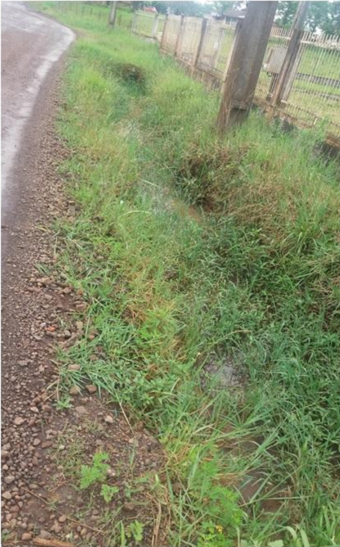
Figura 12: Estrada rumo a Linha Faxinal dos Rosas: dois aterros em banhados na frente de duas residências, lado externo da propriedade
