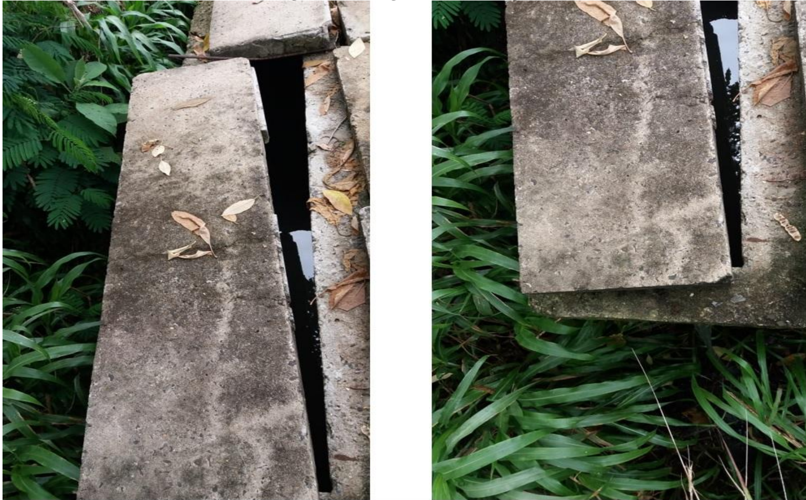
Figura 118: Perigos da caixa de esgoto
